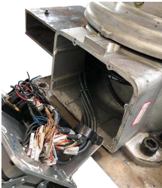
图 11-2 底座内部线缆
